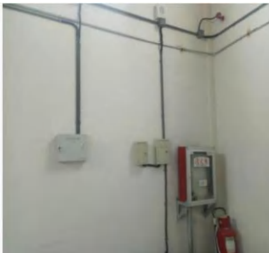
图 4.2-2 火焰探测器、消防设施
