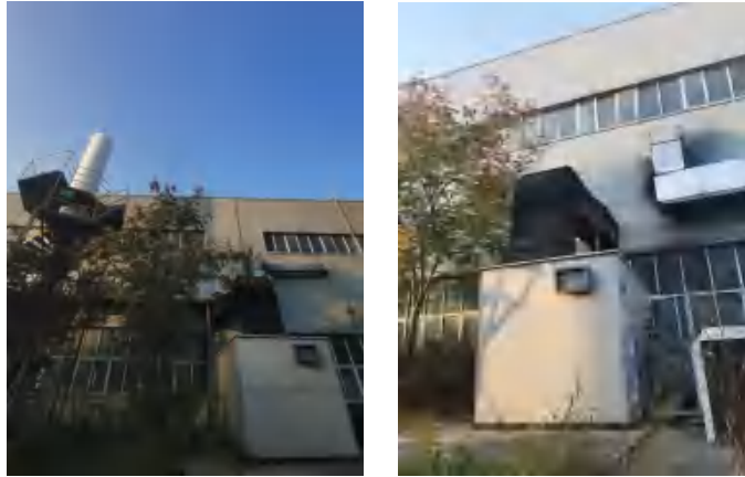
图 4.1-3 废气收集处理装置
